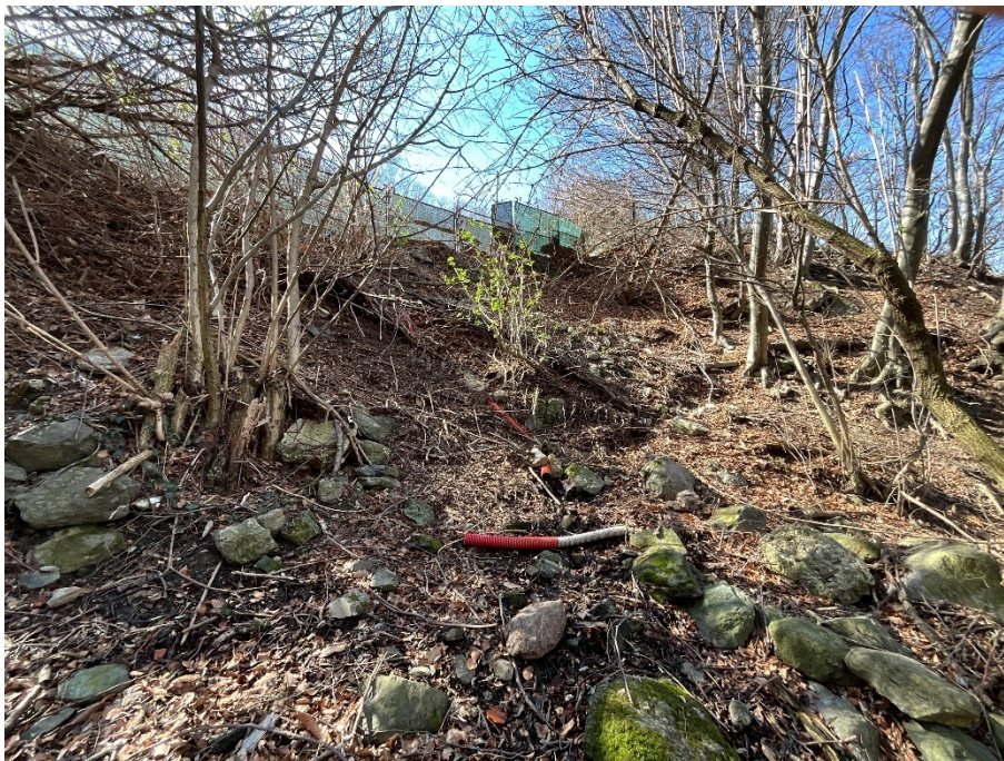
Foto 9 Tubazioni di raccolta acque da ripristinare
